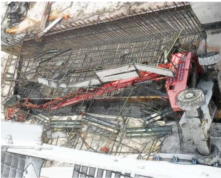
Σκηνή Ατυχήματος – Εξοπλισμός Εργασίας που ανατράπηκε
