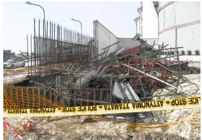
Σκηνή Ατυχήματος – Εξοπλισμός Εργασίας που ανατράπηκε
