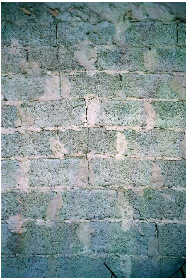
Ακαυτη πλευρά τσιμεντολιθοδομής, θραύση λίθων, ρωγμή τοίχου, ελαφριά κύρτωση. [8]
