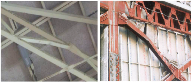
Εικόνα 6: Τοπικός λυγισμός μεταλλικών στοιχείων λόγω ανεμοπίεσης
