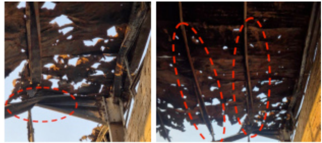
Εικόνα 10: Λυγισμός σε επίπεδο διατομής κύριας δοκού (αριστερά) και Στρεπτοκαμπτικός λυγισμός τεγίδων (δεξιά)
