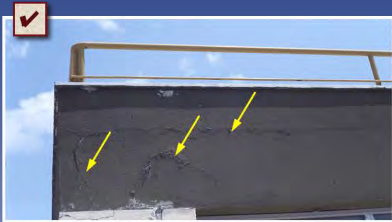
Φθορές του εξωτερικού επιχρίσματος στο περιμετρικό στηθαίο
