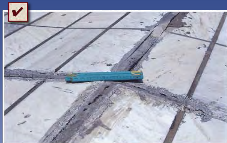
Καταστροφή του υλικού πλήρωσης αρμών
