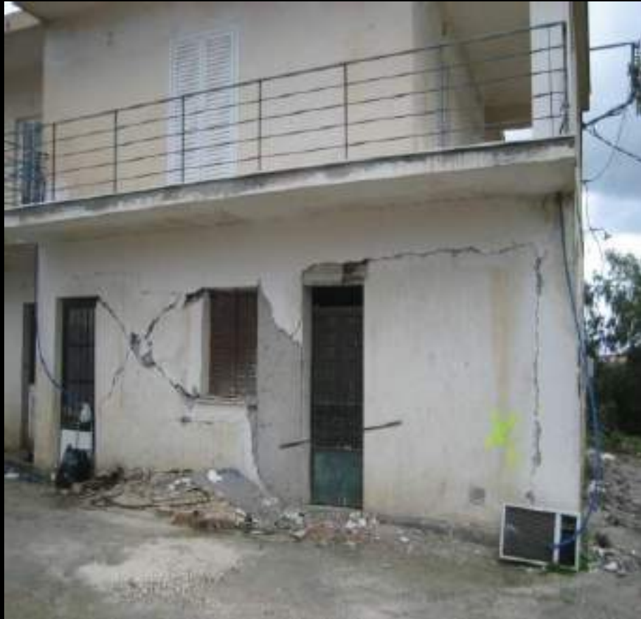
Κεφαλονιά, μετά τον 1 ο Σεισμό (26.01.2014 )
