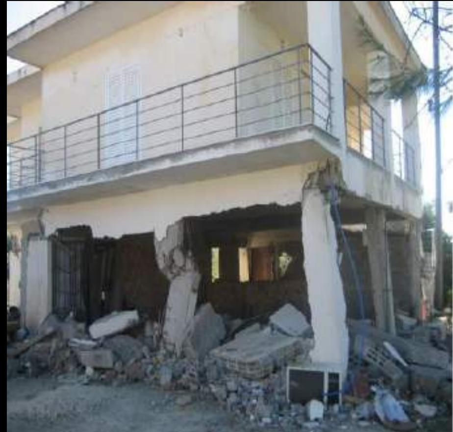
Κεφαλονιά, μετά τον 2 ο Σεισμό (03.02.2014 )
