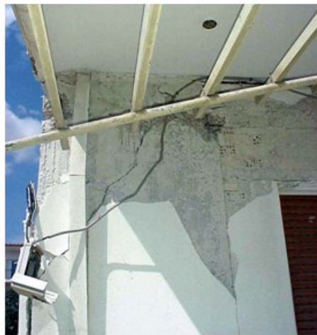
Φωτ. 17: Βαθμός βλάβης 3
