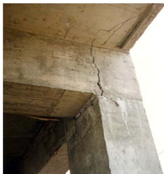
Φωτ. 15: Βαθμός βλάβης 3
