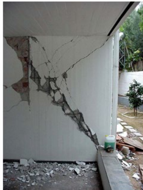
Φωτ. 12: Βαθμός βλάβης 4
