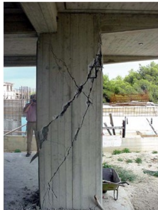
Φωτ. 8: Βαθμός βλάβης 4
