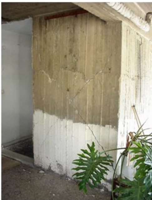
Φωτ. 9: Βαθμός βλάβης 2-3
