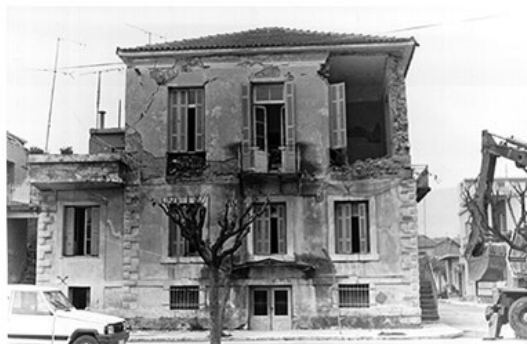
Φωτ. 32: Μερική κατάρρευση (ΚΟΚΚΙΝΟ)
