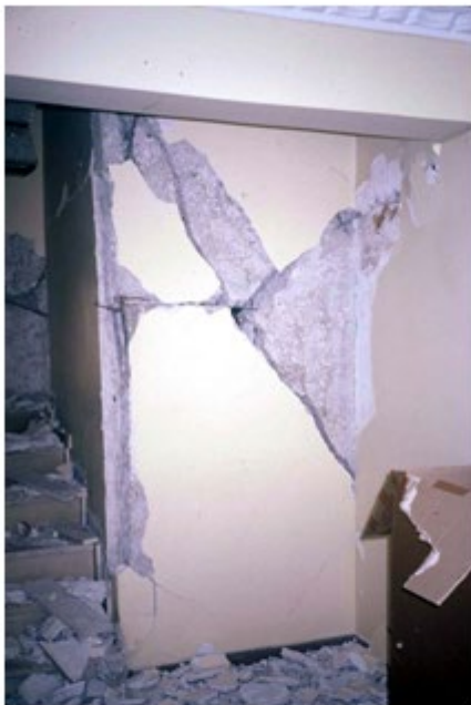
Φωτ. 11: Βαθμός βλάβης 4
