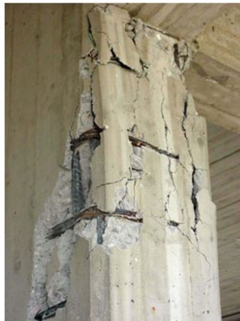
Φωτ. 4: Βαθμός βλάβης 3
