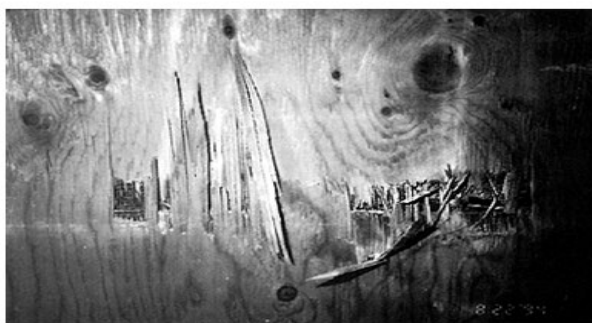
Φωτ. 39: Τοπική βλάβη ξύλινου διατημητικού τοίχου (ΚΙΤΡΙΝΟ)
