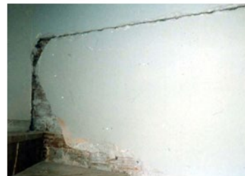
Φωτ. 24: Βαθμός βλάβης 3
