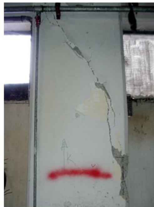
Φωτ. 6: Βαθμός βλάβης 3
