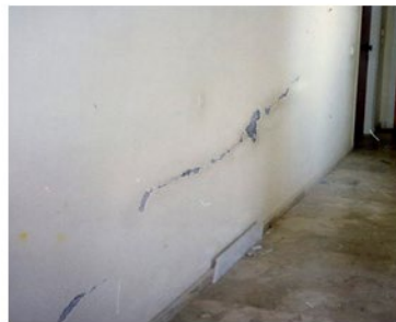
Φωτ. 21: Βαθμός βλάβης 1-2
