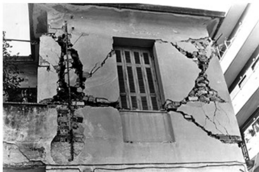
Φωτ. 30: Σοβαρές βλάβες (ΚΟΚΚΙΝΟ)
