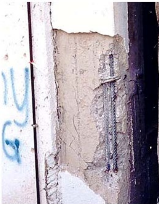
Φωτ. 3: Βαθμός βλάβης 2
