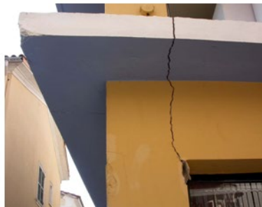
Φωτ. 14: Βαθμός βλάβης 2-3
