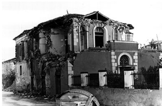
Φωτ. 31: Μερική κατάρρευση (ΚΟΚΚΙΝΟ)
