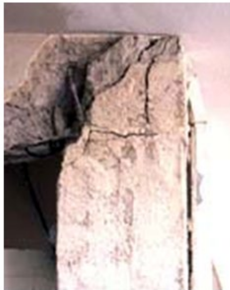
Φωτ. 19: Βαθμός βλάβης 4
