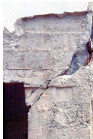
Φωτ. 18: Βαθμός βλάβης 4
