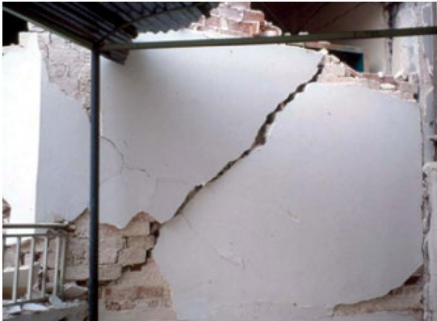
Φωτ. 26: Βαθμός βλάβης 4
