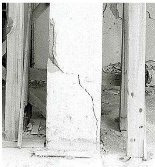
Φωτ. 5: Βαθμός βλάβης 3
