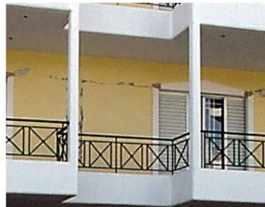
Φωτ. 22: Βαθμός βλάβης 2
