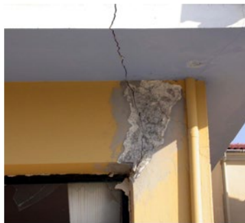
Φωτ. 13: Βαθμός βλάβης 2
