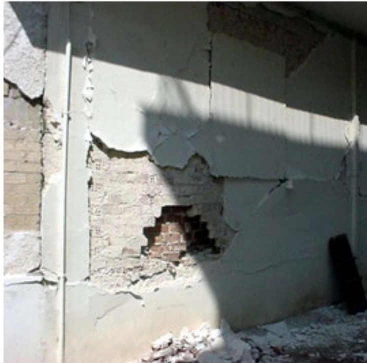
Φωτ. 25: Βαθμός βλάβης 4
