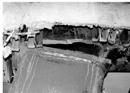
Φωτ. 36: Σπασμένη συγκόλληση πλάκας σε κόμβο στύλου-δοκού (ΚΙΤΡΙΝΟ)
