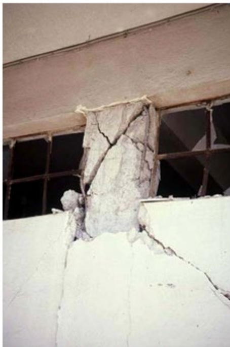
Φωτ. 7: Βαθμός βλάβης 4
