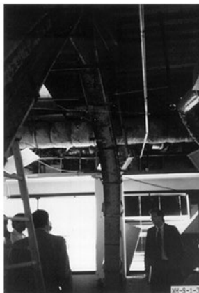
Φωτ. 34: Λυγισμένο αντιανέμο μέλος κτηρίου
