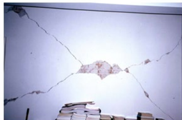
Φωτ. 23: Βαθμός βλάβης 3
