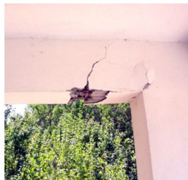
Φωτ. 16: Βαθμός βλάβης 3
