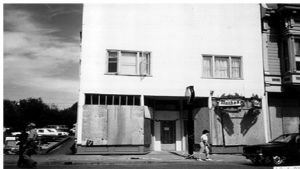
Φωτ. 38: 2-ώροφο κτήριο πλαίσιακού τύπου με βλάβες. Εκτεταμένες θραύσεις υαλοπινάκων και πλευρική κλίση (ΚΙΤΡΙΝΟ)
