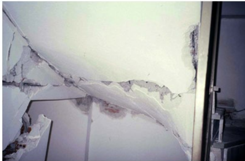
Φωτ. 20: Βαθμός βλάβης 2-3
