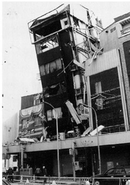
Φωτ. 37: Αστοχία 7-ώρου χαλύβδινου κτηρίου με διαγώνια μέλη (ΚΟΚΚΙΝΟ)
