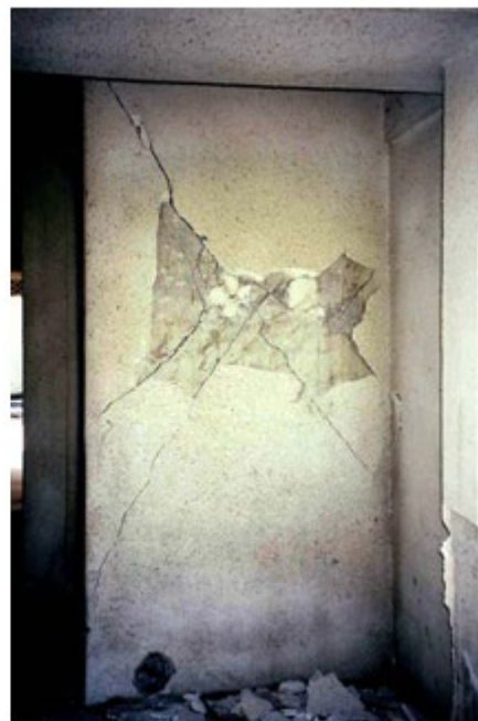
Φωτ. 10: Βαθμός βλάβης 2-3
