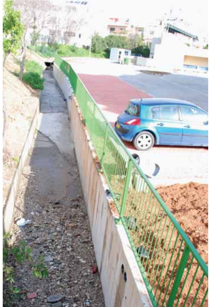
Τσιμεντωμένο αργάκι δίπλα στο κολυμβητήριο. Η περιοχή είχε πρόσφατα πρόβλημα υπερχείλισης. Η πρόσφατη κατασκευή χώρου στάθμευσης δεν αντιμετώπισε το πρόβλημα.
